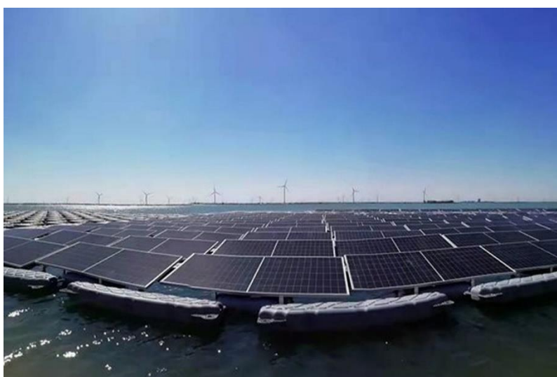
Figura 4.29: Impianto Fotovoltaico galleggiante a Dezhou (Cina)
